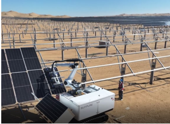
图 4 光伏电站智能运维作业现场
